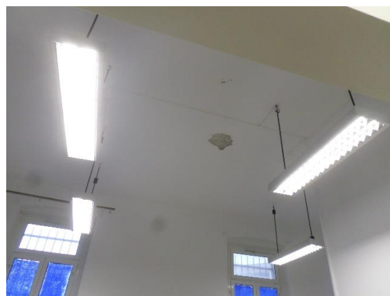
Figura 4.10 - Particolare dei corpi illuminanti installati nelle aule
