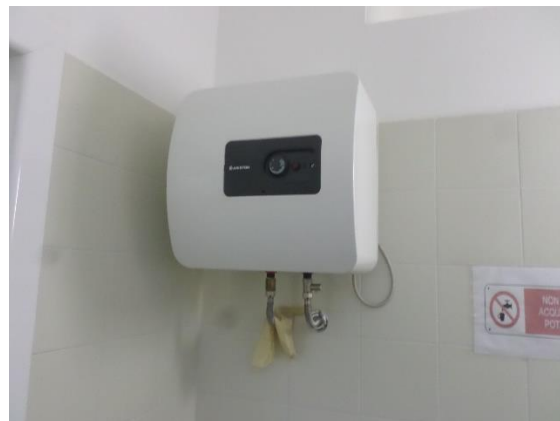
Figura 4.9 - Particolare di un boiler elettrico per la produzione di acqua calda sanitaria
