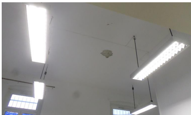
Figura 8.11- Particolare dei corpi illuminanti attualmente installati
