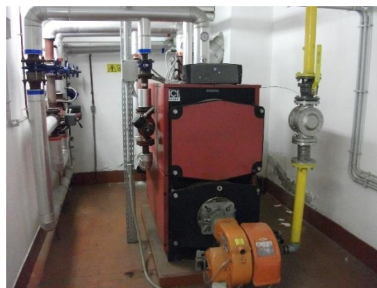
Figura 8.6- Particolare del generatore di calore attualmente installato
