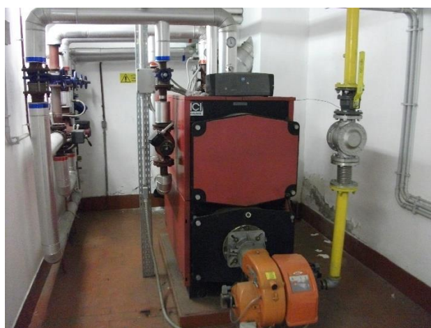
Figura 4.8 - Particolare di caldaia a basemento
