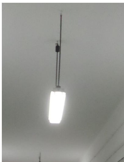
Figura 4.11 - Particolare dei corpi illuminanti installati nei corridoi
